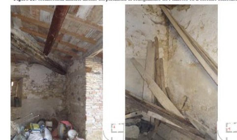
Figura 23: sconnessioni murarie interne dei paramenti di collegamento
