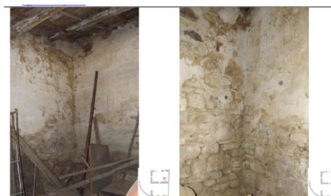
Figura 22: sconnessioni murarie interne dei paramenti di collegamento tra l'annesso ed il casolare adiacente
