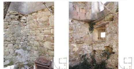
Figura 17: Sconnessioni murarie nell'ambiente sud, tra l'annesso ed il casolare adiacente
