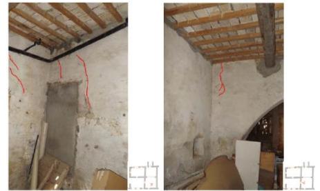
Figura 28: lesioni sul vano porta della parete ovest e in corrispondenza dell'innesto tra questa e l'arco centrale
