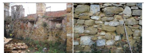
Figura 16: Interno del paramento sud dell'annesso e particolare del degrado legato all'azione dei nitrati
